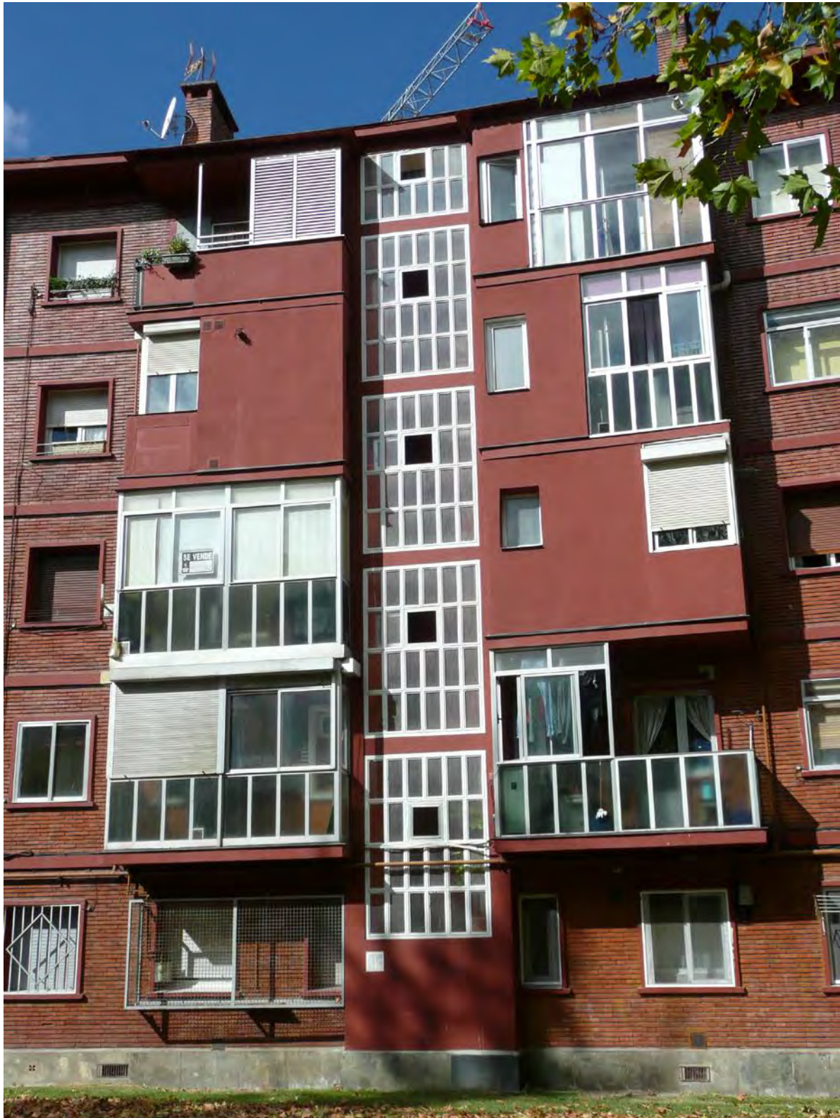
Bloque de Zaramaga, estado actual de la alterada fachada este
