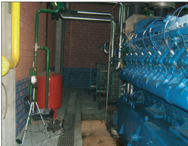
Inspección con cámara termográfica de los pistones del motor Deutz TCG2020V20 de Cogeneración Bergara AIE
