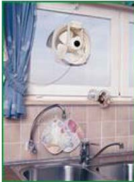
Ventilador en la ventana de una cocina
