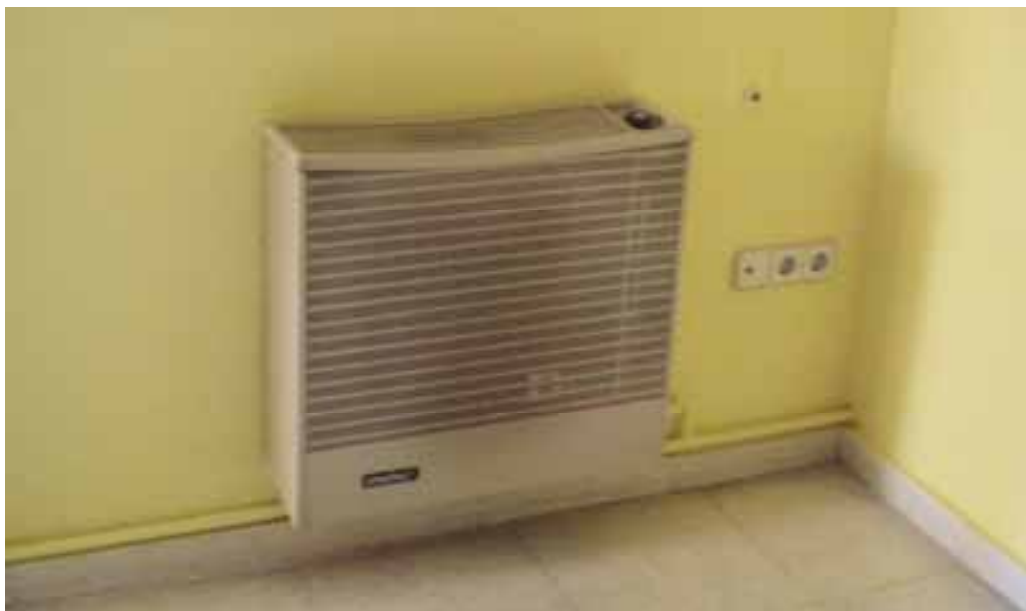
Foto 1.4. Aparato de calefacción obsoleto a sustituir.
