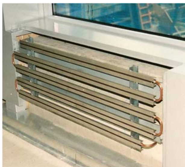
Foto A2.7. Pared radiante instalada en un edificio de oficinas (Fuente: Zent-Frenger).
