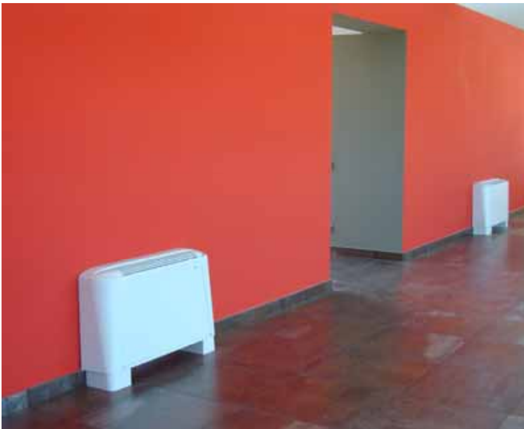
Foto A2.13. Fancoils de pared (Fuente: Ferroli).
