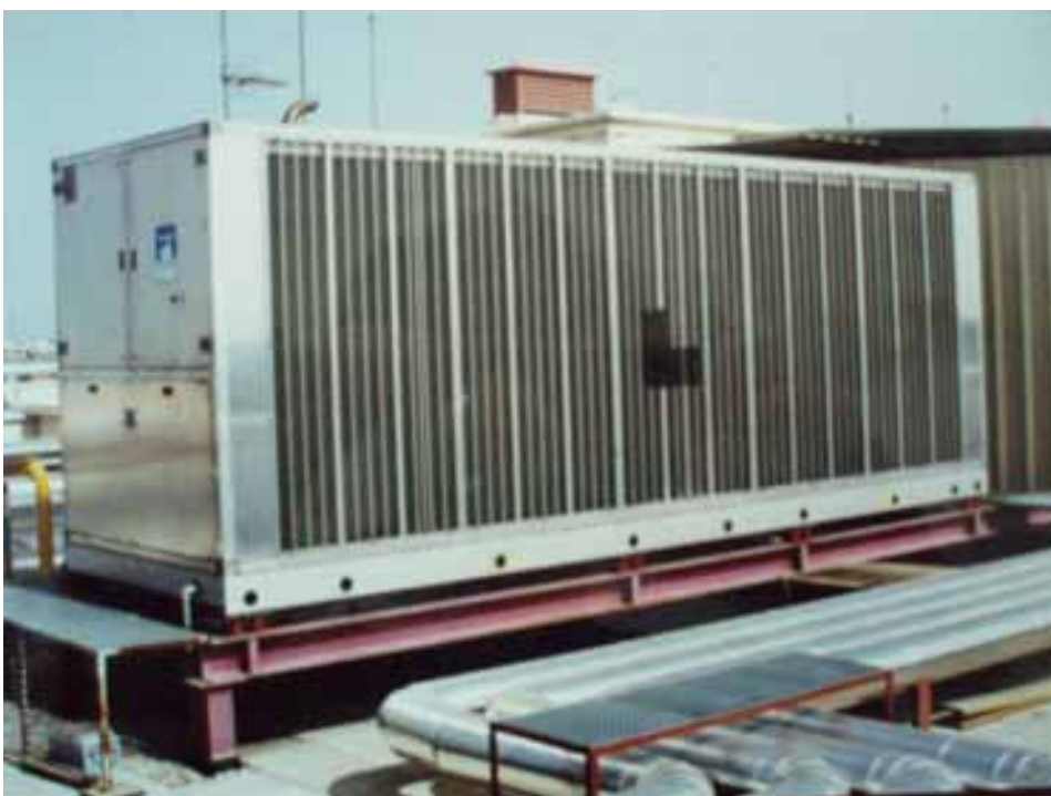
Foto A1.6. Batería de frío instalada en las oficinas del aeródromo de Cuatro Vientos.
