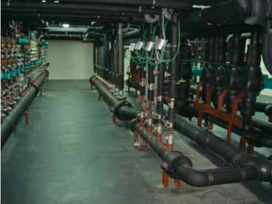
Foto A2.8. Instalación sala técnica (Fuente: Ferrolí).
