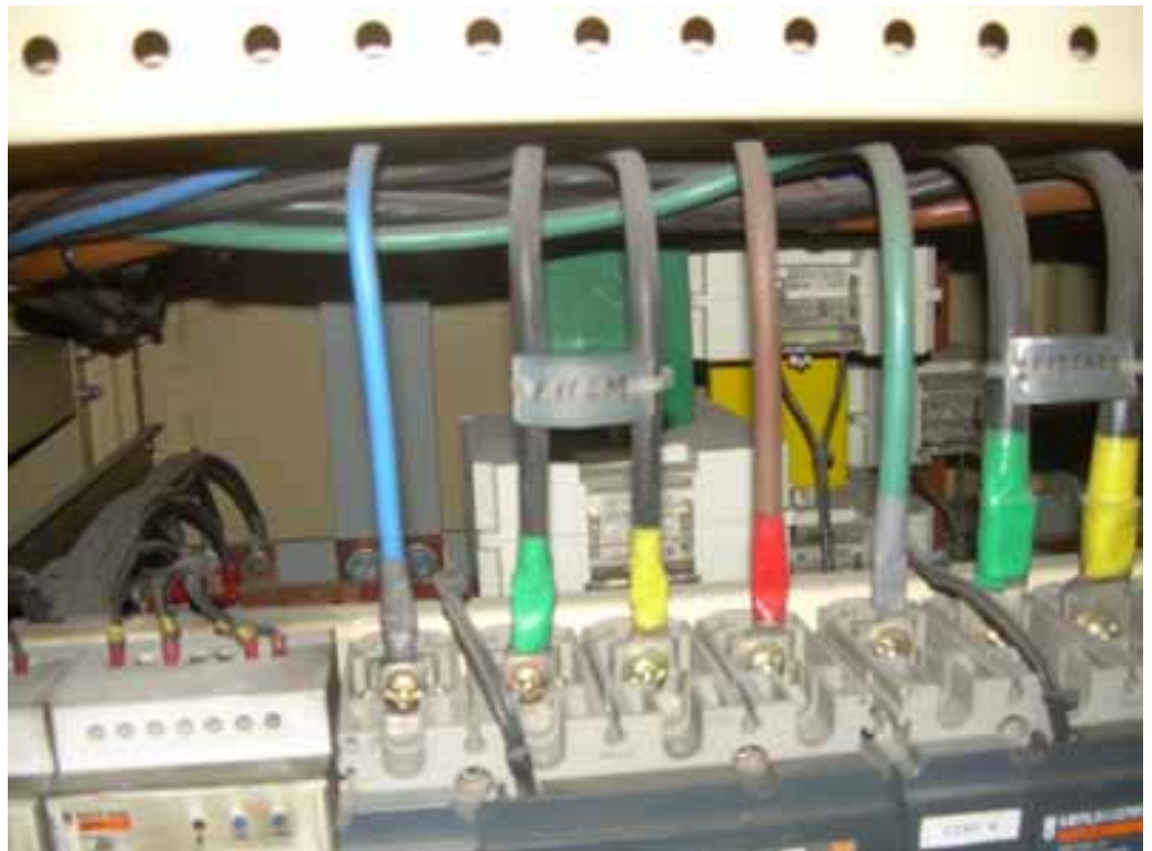
Foto 3.2. Cuadro eléctrico de acometida a transformador.
